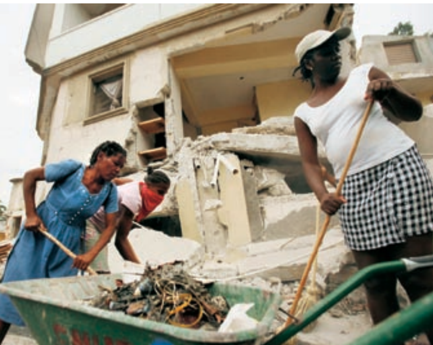
▲ Haïtiennes nettoyant les gravats dans les rues dans le cadre d'un programme « travail contre numéraire » dans le quartier de Carrefour Feuille de Port-au-Prince.
