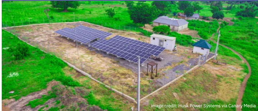
Un micro-réseau au Nigeria - crédit photo : Husk Power Systems via Canary Media
